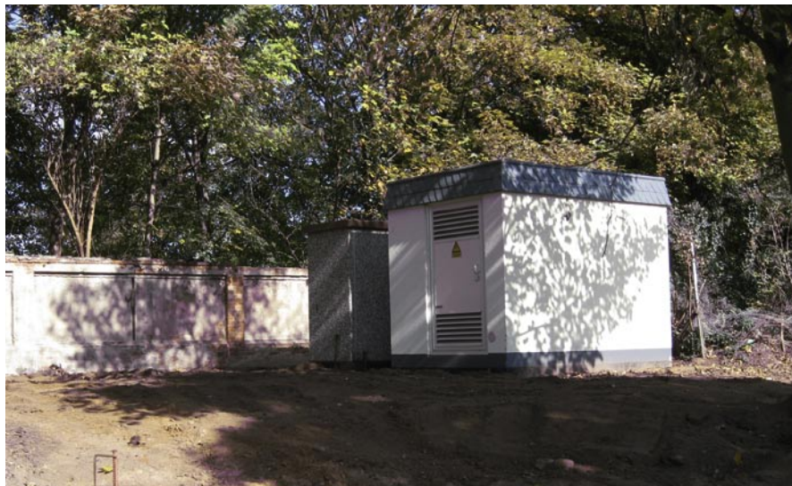
Mit den neuen Anlagen kommt es zur Stabilisierung der Stromversorgung in der Innenstadt.
